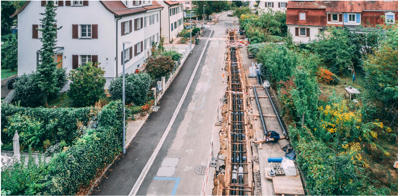
▲ Abb. 1: Im Versorgungsnetz des Wärmeverbunds Riehen steckt viel Geothermie.
