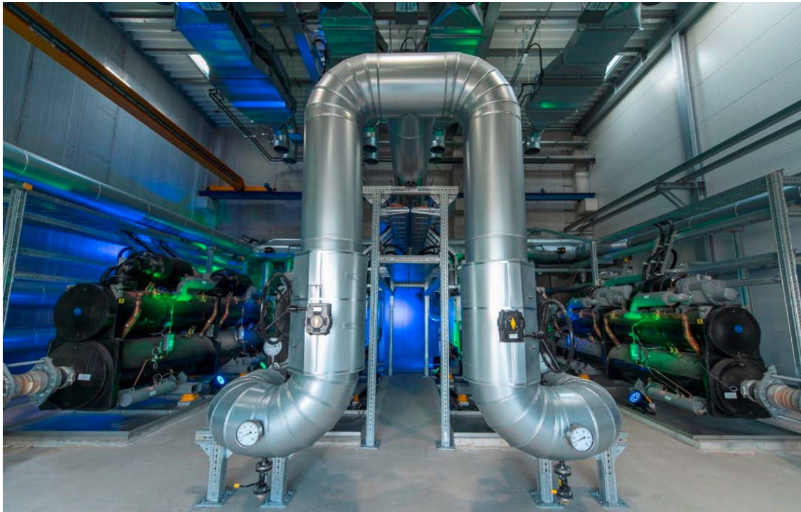
◀ Abb. 1: Die Hochleistungswärmepumpen bilden das Herzstück des Geothermie-Heizwerks und machen die Anlage bislang einzigartig in Deutschland.
