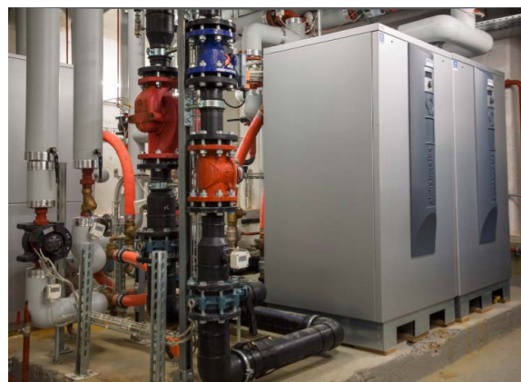
▲ Abb. 3: Diese Wärmepumpen erzeugen das Warmwasser und bringen das Wasser für die Heizung auf das benötigte Temperaturniveau.
