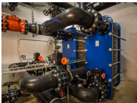
▲ Abb. 2: Diese Wärmetauscher werden mit Wärme aus dem Grundwasser gespeist und sorgen für die Verteilung der Wärme im Kältenetz zu den in den Gebäuden installierten Wärmepumpen.
